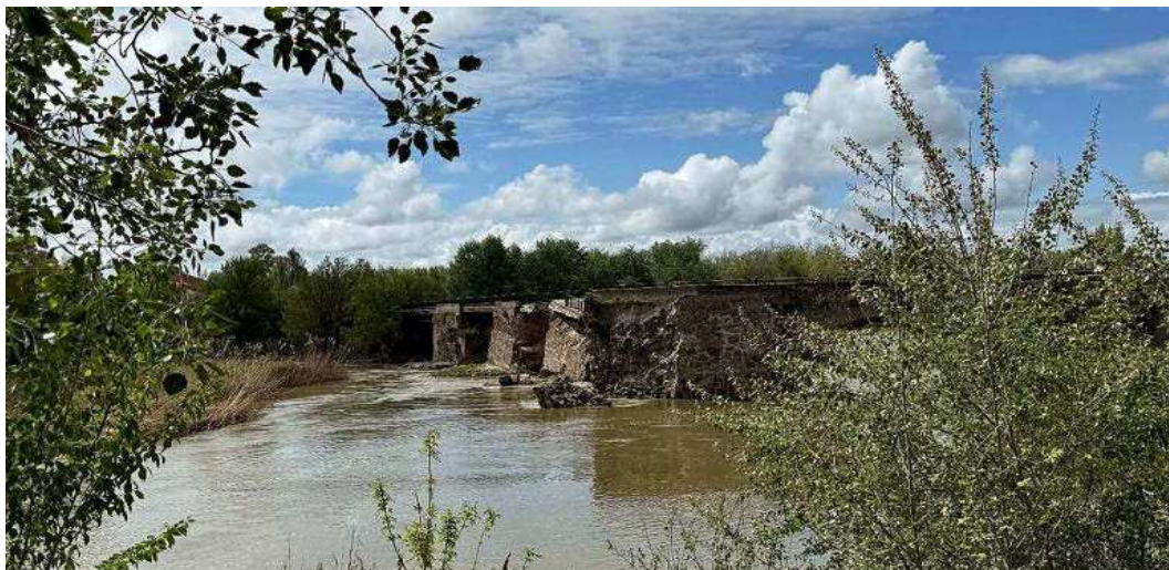
Los restos desprendidos de la estructura del Puente Viejo ya han comenzado a aflorar con la bajada del nivel del río. / C.S.J.
